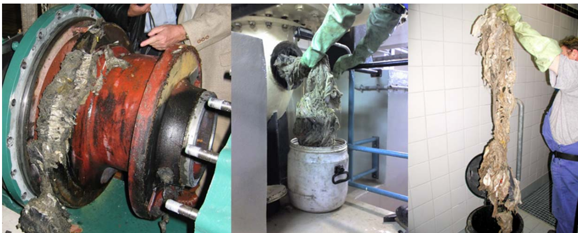
Abbildung 8: Pumpenverstopfungen durch Pumpenzöpfe aus Vliesstoffen
